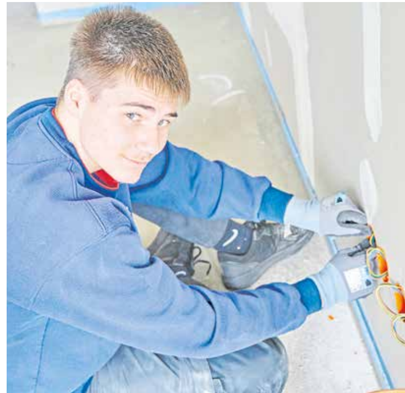
Frederic beim Einsetzen von Gerätedosen auf der Baustelle eines neu entstehenden Autohauses. Wie alle Praktikanten wechselte er die Baustellen während des Praktikums für einen größtmöglichen Einblick in den Beruf.
