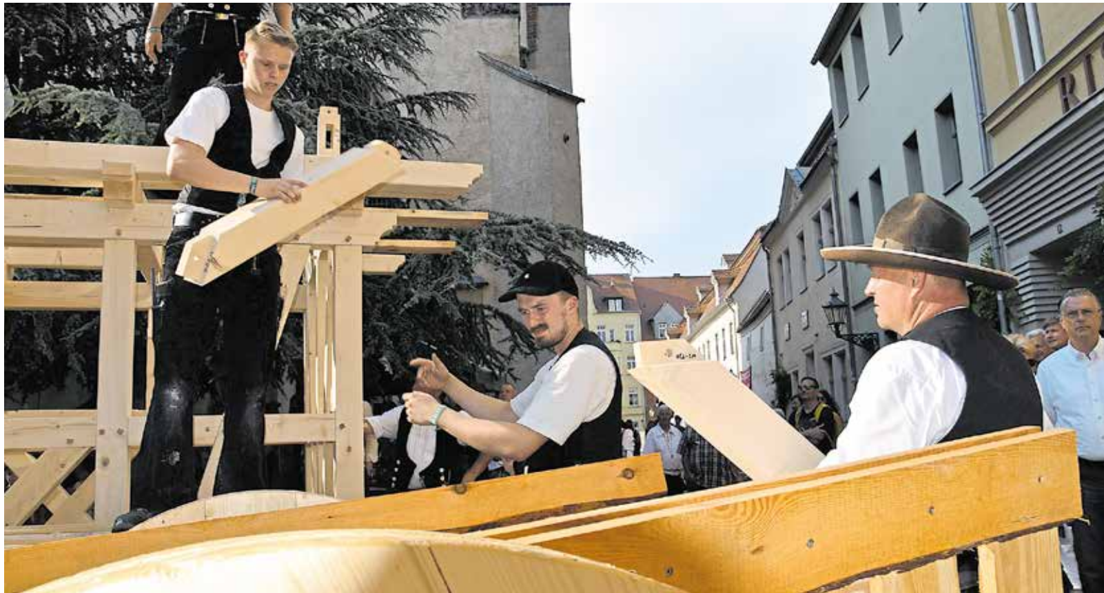
Große Aktion auf „Luthers Hochzeit“: Um Handwerk sichtbar zu machen, hatten sich die Bauinnung sowie ansässige Zimmereien und Dachdeckereien überlegt, vor Ort einen Fachwerkhaus-Rohbau zu errichten. Bei den Festbesuchern kam das gut an. Fotos: HWK Halle/Yvonne Bachmann
