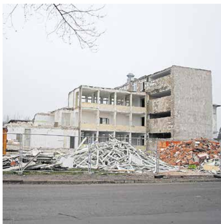
Die Abrissarbeiten sind beendet. Die nächsten Schritte im Baugebiet sind die Herstellung des Planums und der Beginn der Tiefbauarbeiten.
