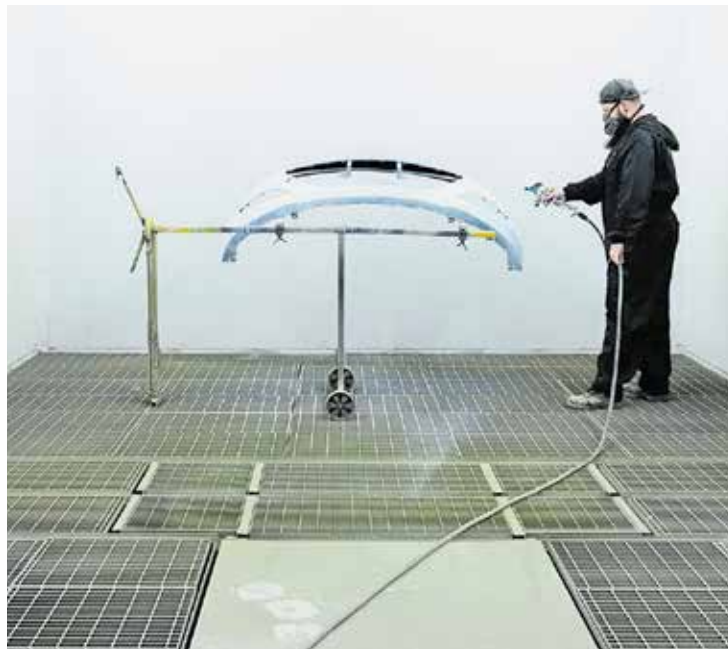
Im Rahmen der geförderten Investitionen wurde in der Identica AW-technic GmbH eine neue Lackierkabine installiert, die mit mehreren Vorbereitungs- und Multifunktionsarbeitsplätzen kombiniert wurde. Diese wurden mit energiesparender LED-Beleuchtung ausgestattet. Foto: AW-technic GmbH
