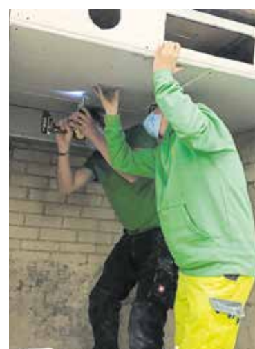
Die Tiefbau-Lehrlinge erhielten bei der ÜLU einen Einblick in ein anderes Fachgebiet. Foto: HWK Halle/Anne Rotfuß
