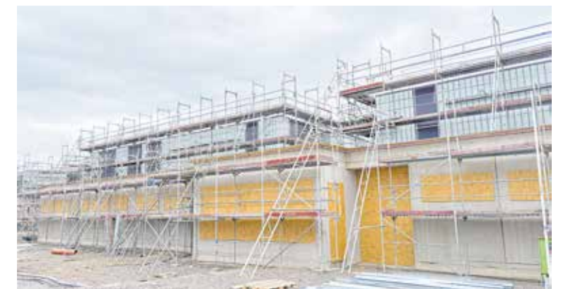
Die Werkstattgebäude für Elektro-, SHK- und Metalltechnik auf der Südseite sind im oberen Bereich bereits mit Profilbauglasfassaden geschlossen. Dank provisorisch abgedichteter Fenster kann der Innenausbau uneingeschränkt weiterlaufen. Foto: HWK Halle/Tobias Kirchner
