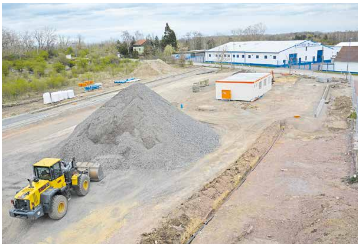
Eine Kamera zeichnet den Fortschritt der Bauarbeiten stündlich auf. Auf der Webseite der Handwerkskammer kann somit jeder mitverfolgen, wie die Baustelle gerade aussieht. Foto: HWK Halle/Jens Schumann
